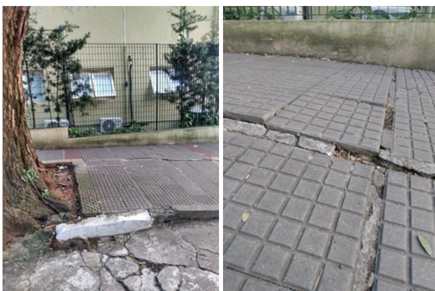
Imagem 1. Local do acidente antes do reparo
